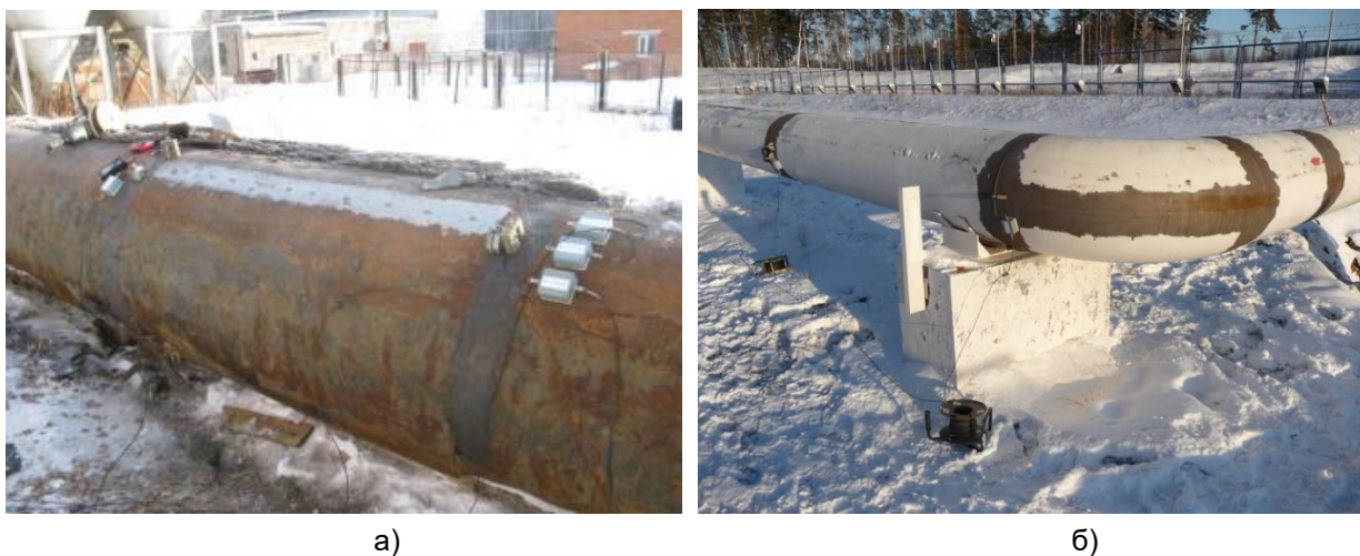
Рис. ПЗ.21. Экспериментальные исследования: а) искусственный дефект 1700 x 130 мм; б) труба, выходящая из камеры приема-пуска снаряда
