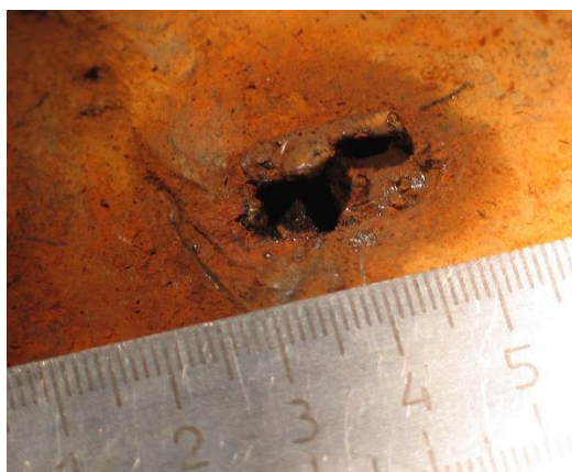
Рис. 10.45. Причина течи – сквозной дефект
